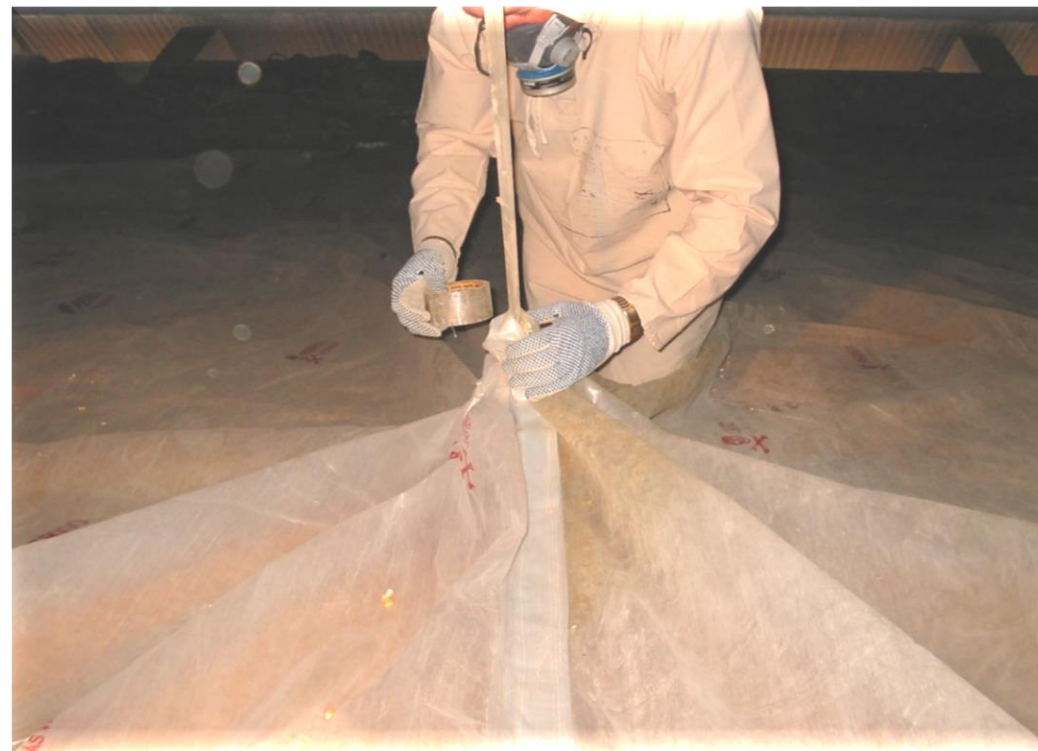
VEDAÇÃO NOS CABOS DE TERMOMETRIA
