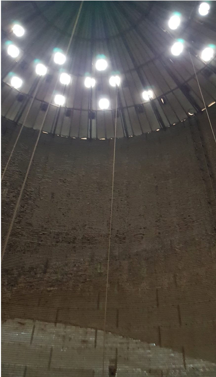
Foto interior do silo depois da instalação do “Cycloar Lux”
