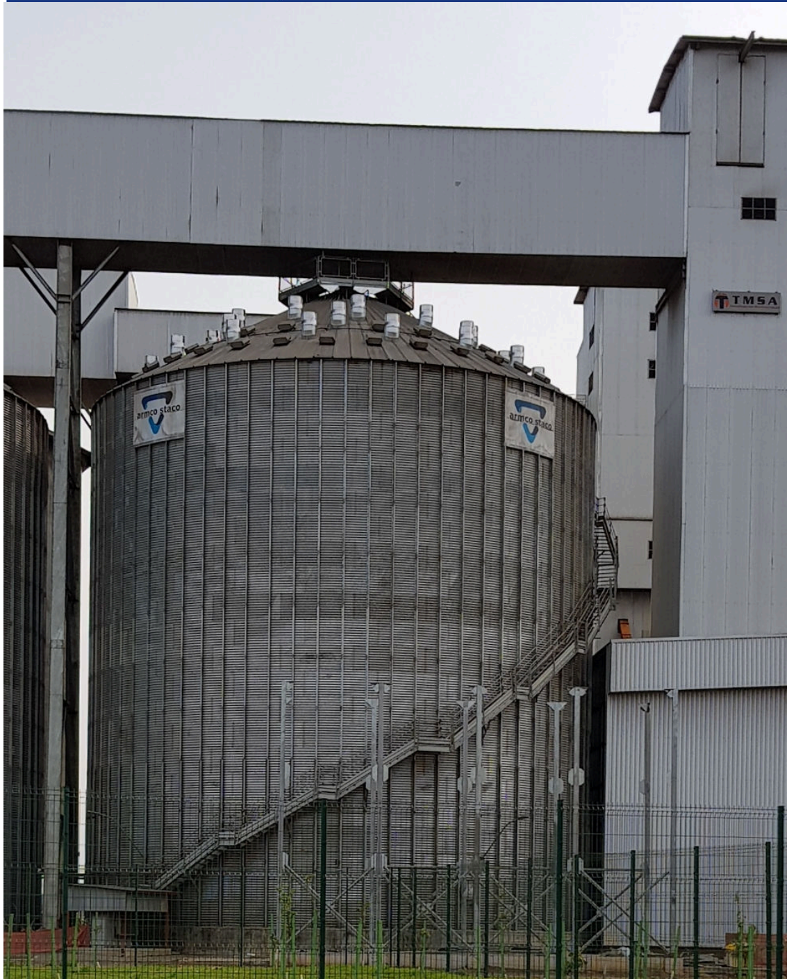
Foto do silo 3- equipamento Cycloar Lux instalado
